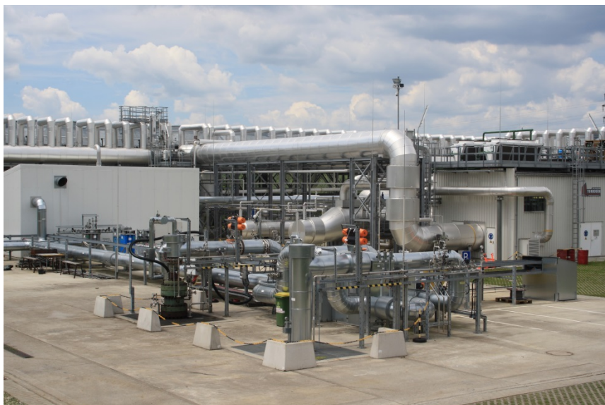
Geothermianlage in Dürnhaar
