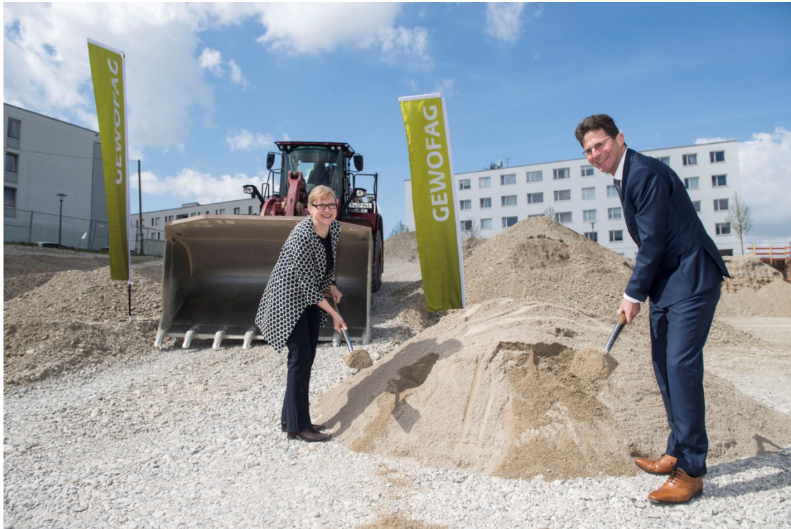
Stadträtin und Aufsichtsratsmitglied Renate Kürzdörfer und Dr. Klaus-Michael Dengler beim Spatenstich für die Messestadt Riem-Ost (Foto: Lukas Barth).
