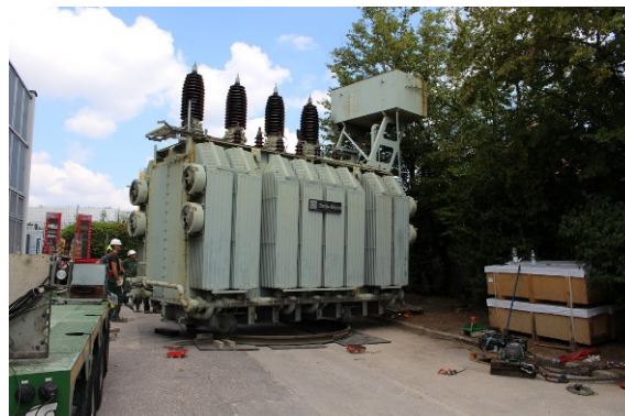
Generationswechsel beim Groß-Trafo: Neu und alt (rechtes Foto) im Vergleich. Der alte Trafo geht nach fast 50 Jahren Betriebszeit in Ruhestand. Fotos: SWM
