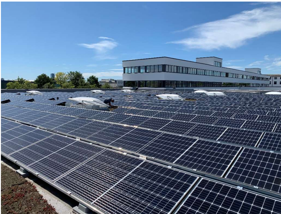
Ein Ausschnitt der 10.000 Quadratmeter großen PV-Anlage auf dem Dach des Centro Tesoro
