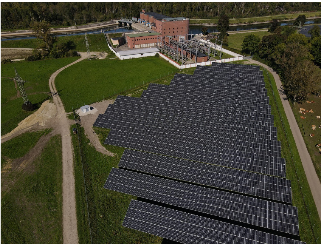
Die Drohnenaufnahme zeigt eine Teilfläche des von den SWM neu errichteten großen Photovoltaik-Parks rund ums Uppenborn-Wasserkraftwerk.
