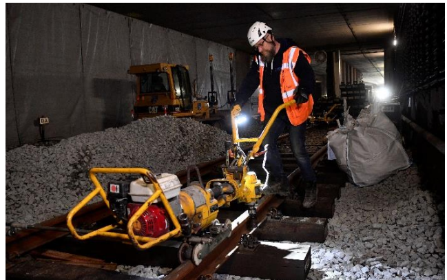
Die neuen Schienen zwischen Harras und Imlerstraße werden an den Schwellen festgeschraubt.
