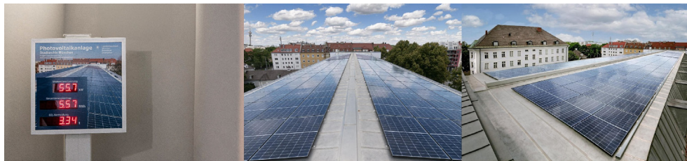
Anzeige-Display und PV-Module am Dach des Stadtarchives (Foto: Jörg Steffens)
