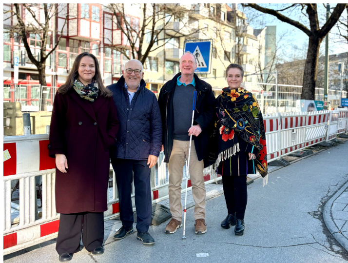
Baustart am Partnachplatz mit (v.l.) Daniela Maier (ehrenamtliche Behindertenbeauftragte der Stadt), Günther Keller (Vorsitzender des Bezirksausschusses Sendling-Westpark), Bernhard Claus (Vorsitzender des Facharbeitskreises Mobilität im Behindertenbeirat) und Baureferentin Dr.-Ing. Jeanne-Marie Ehbauer. (Foto: Baureferat)
